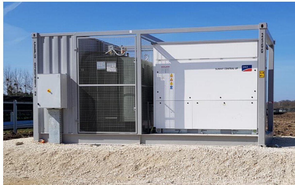
Figure 20 : Poste de transformation
