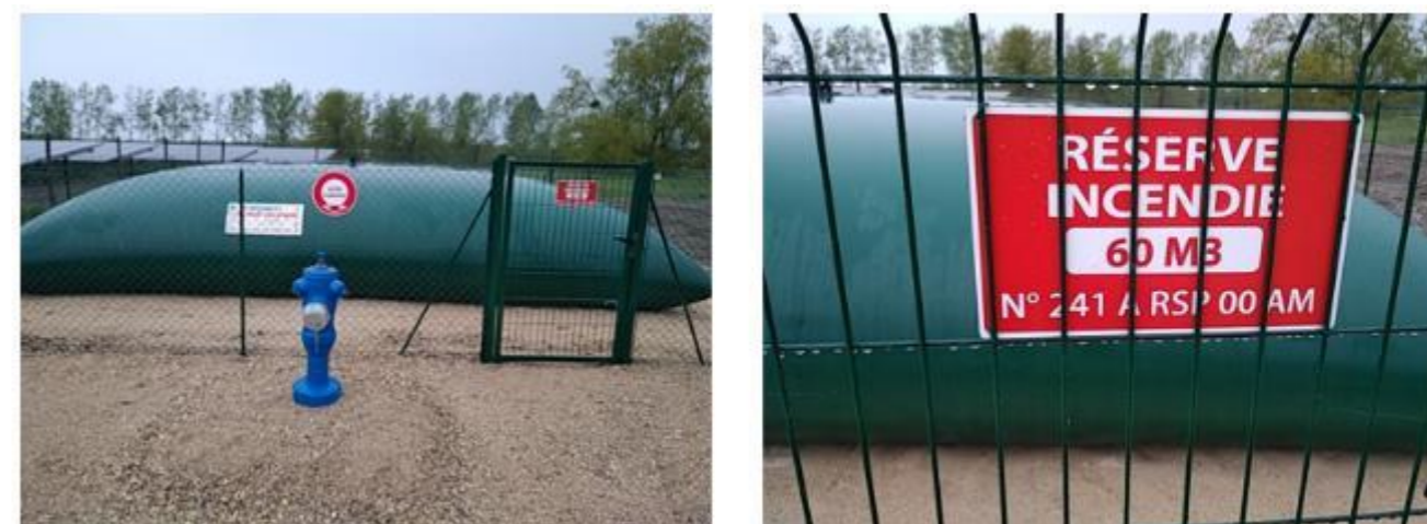
Photographie 1 – Illustration d'une citerne souple de 60 m 3 (source : PHOTOSOL)
