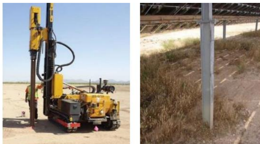
Figure 16 - Technique de fixation des panneaux solaires photovoltaïques
