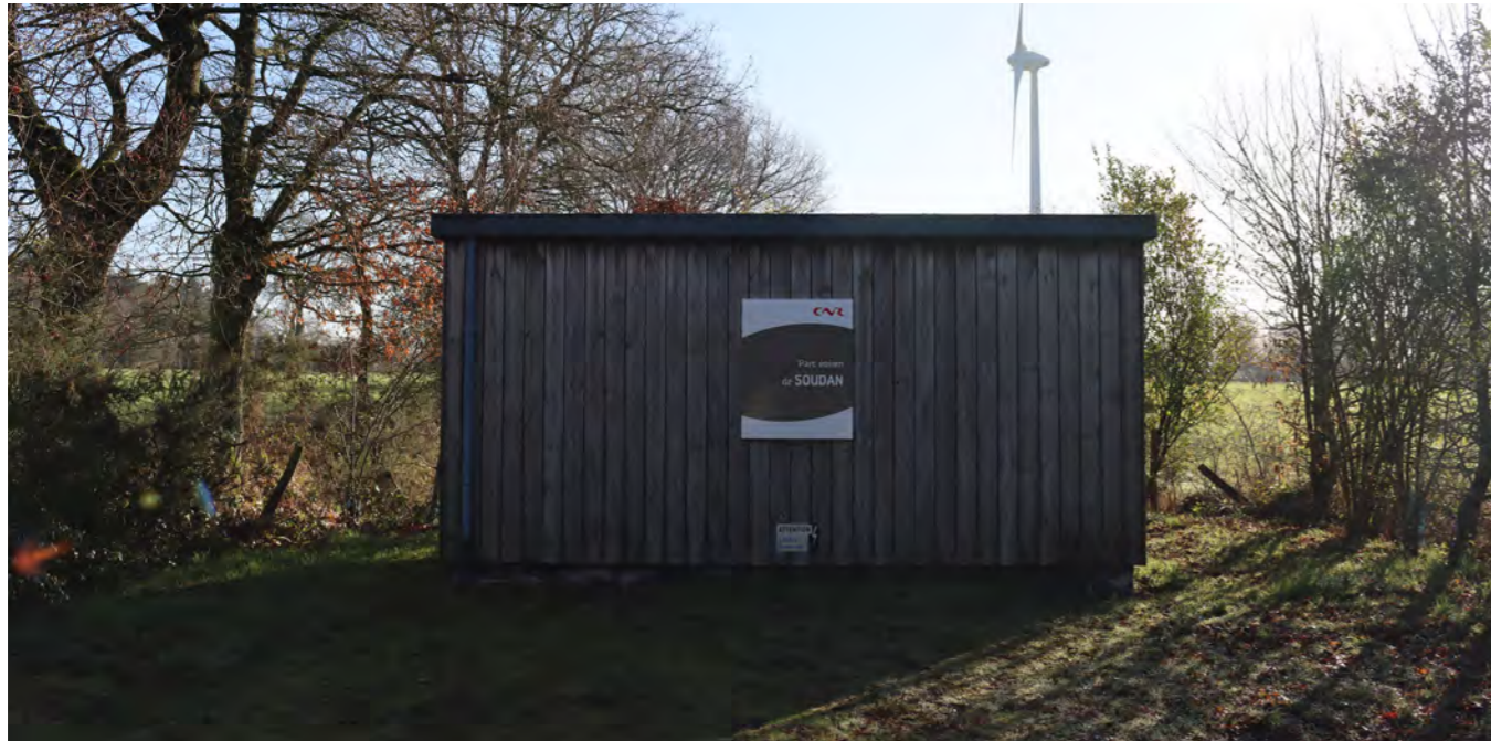
Photographie 64. Poste de livraison du parc éolien de Soudan
