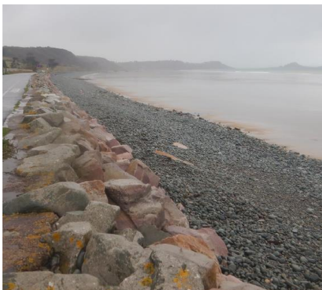
Fig. 48. Enrochement sur la plage de Saint-Pabu
