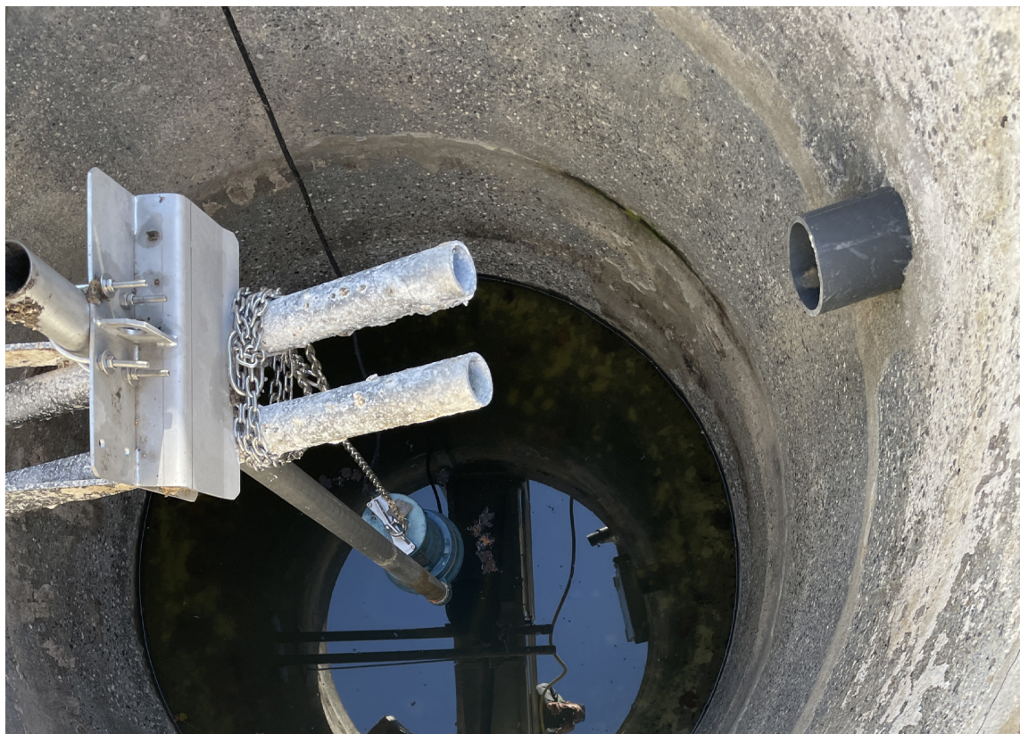
> Vue du dégraisseur
