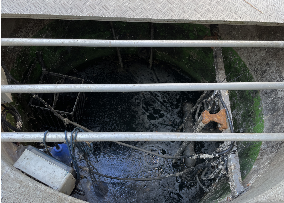
> Le poste de relevage
