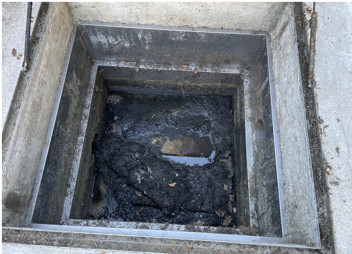
> Emplacement du panier dégrilleur
