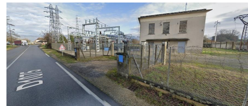
Le poste « source » de Montalieu est à 7 km. (crédit photo Google Street View)
