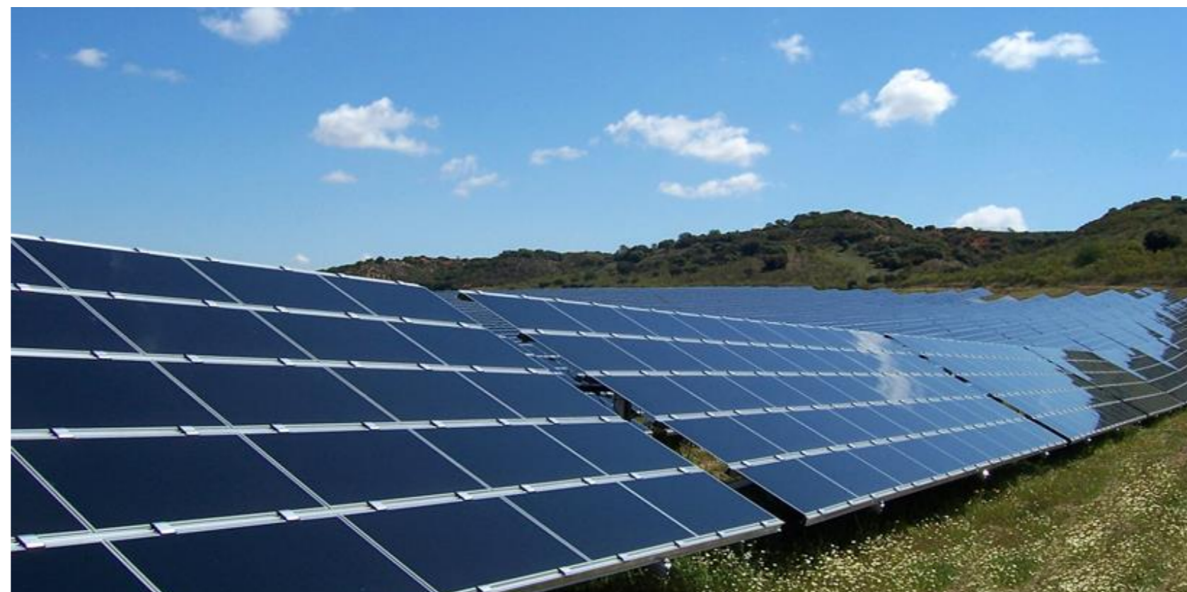
Parc photovoltaïque EDF Renouvelables de Narbonne
