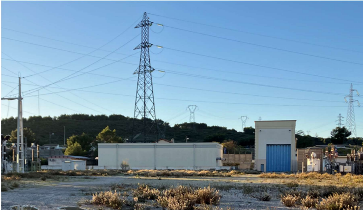
Poste Intérieur Modulaire (PIM) à 63 000 volts de SEPTEMES où seront ajoutés les appareils électriques
