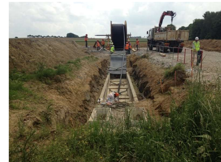
Chambre de jonction et puits de terre au premier plan
