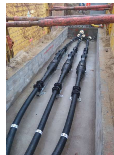
Chambre de jonction
