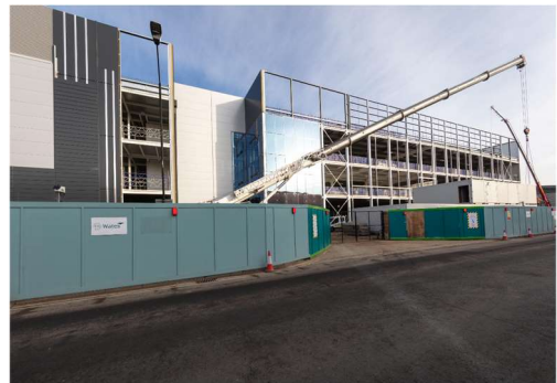
GTR – 40.5 MW IT – Slough (Angleterre)
