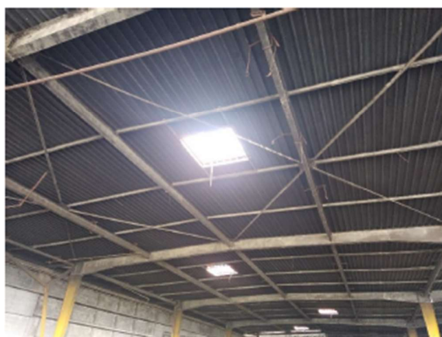
Figure 3 : ouvertures lumineuses sur la toiture métal. (Ecotonia)
