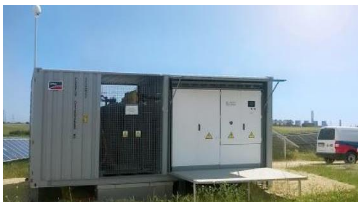
Figure 7 - Exemple de poste de transformation
