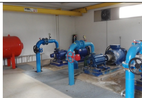
STATION DE TRAITEMENT ET DE REPRISE
