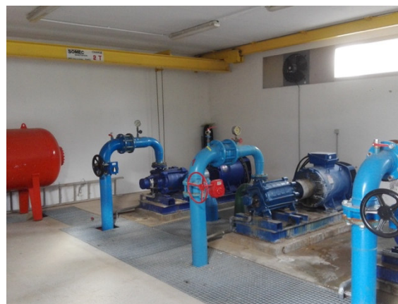
STATION DE TRAITEMENT
