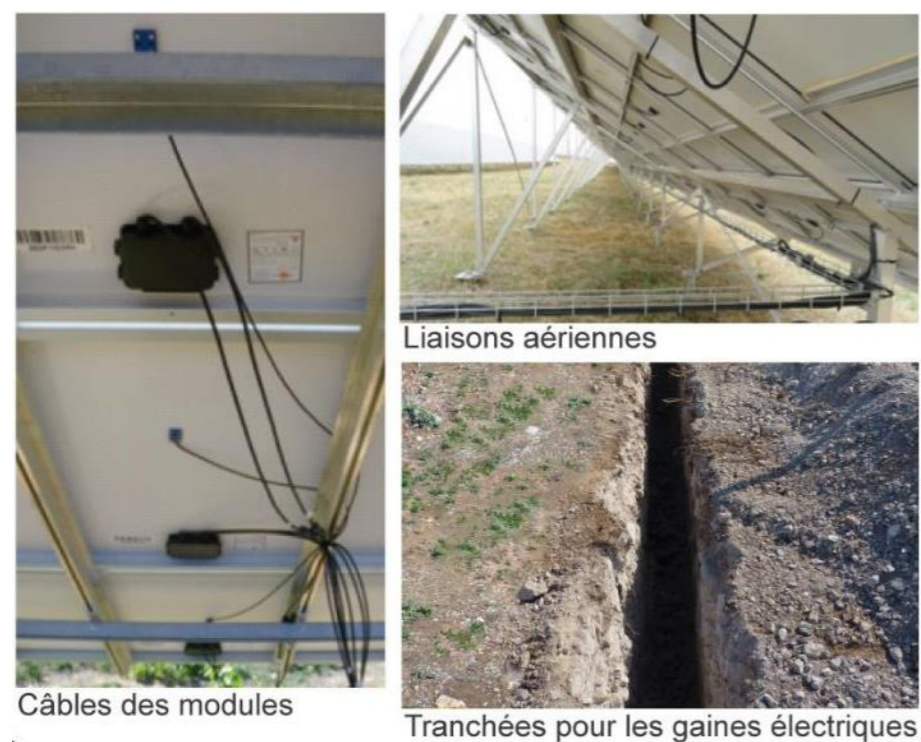
Photographie 8 : Liaisons électriques (Source : ENCIS Environnement)
