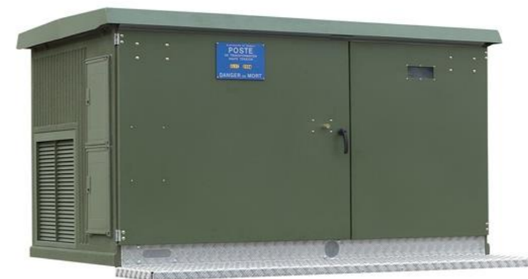
Figure 4 : Poste transformateur (Source : Groupe Cahors)
