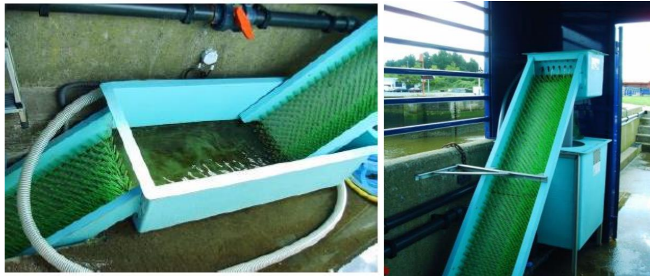
Figure 18 : Bassin de repos situé entre les deux rampes (à gauche) - Seconde rampe et bassin de piégeage (à droite) - Source : Eaux&Vilaine
