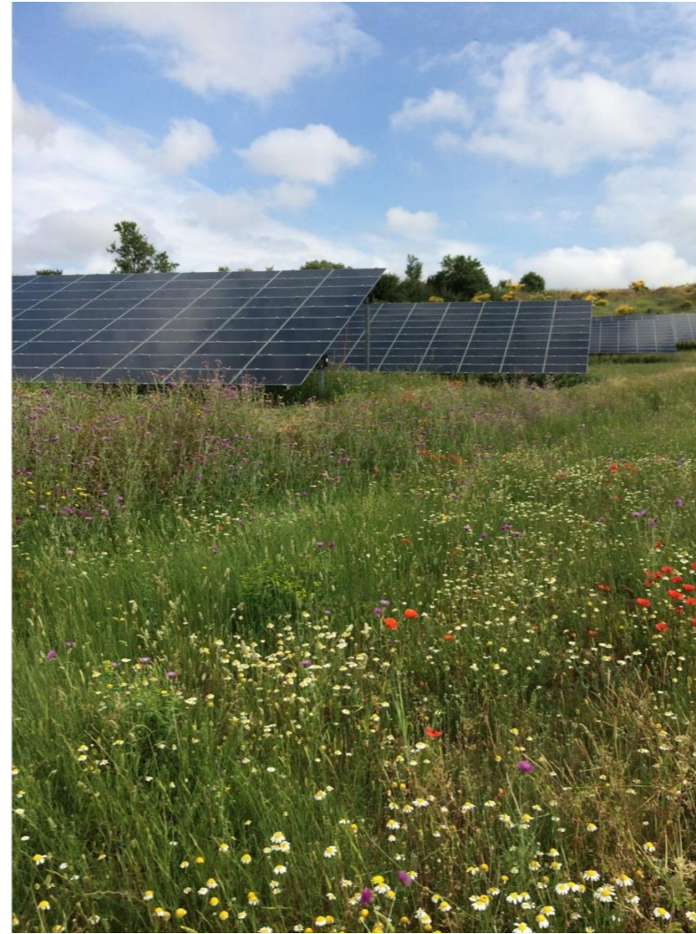
Parc Photovoltaïque EDF Renewables de Narbonne
