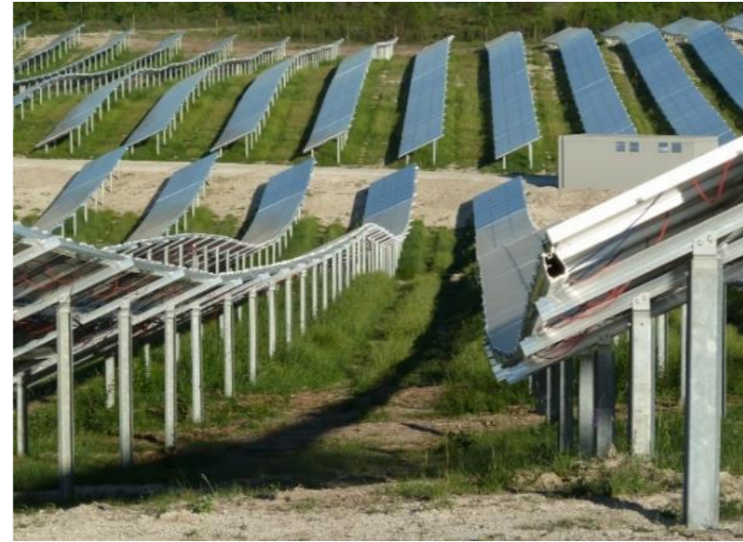
Les structures photovoltaïques s'adaptent à la topographie (crédit photo : EDR RE)
