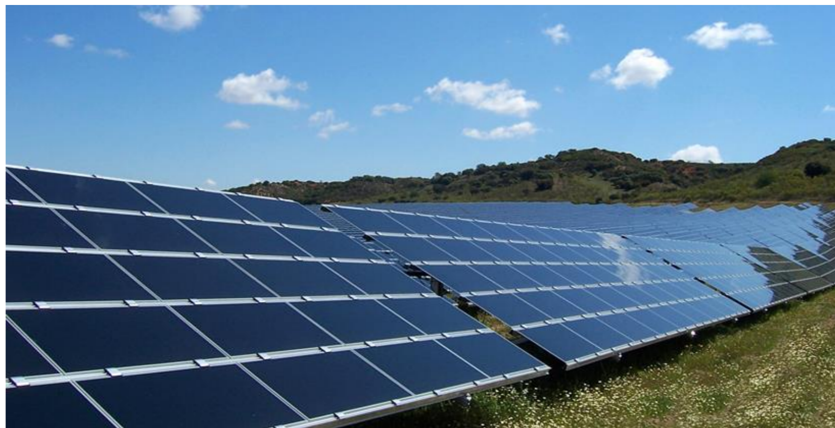
Parc photovoltaïque EDF Renouvelables de Narbonne
