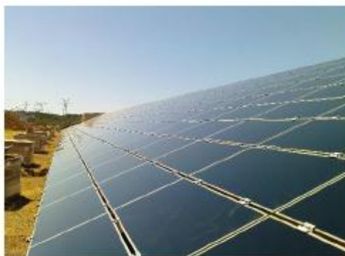
Modules photovoltaïques (Source : EDF Renouvelables France)
