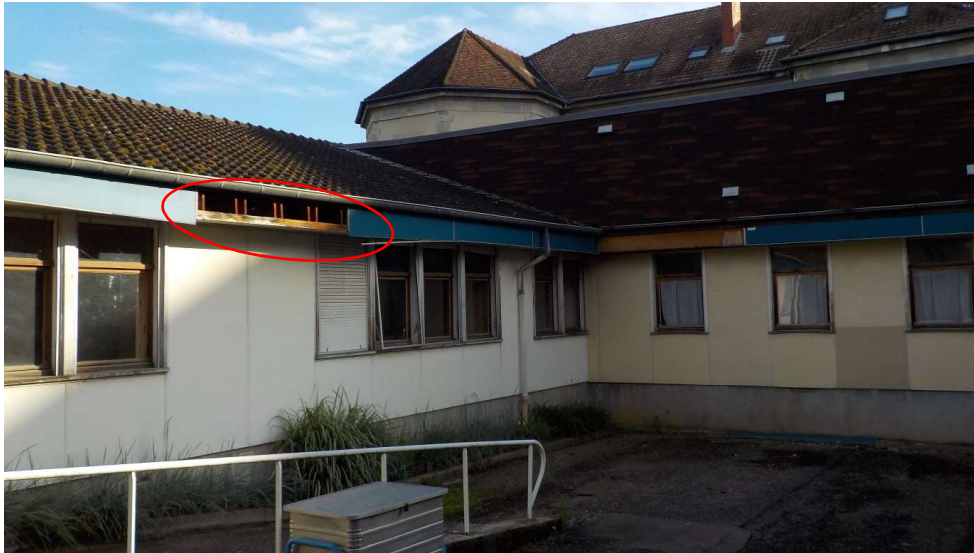
Photo n°4. Exemple de bâtiment récent délabré, avec un accès possible sous les toitures potentiellement favorables pour les chiroptères
