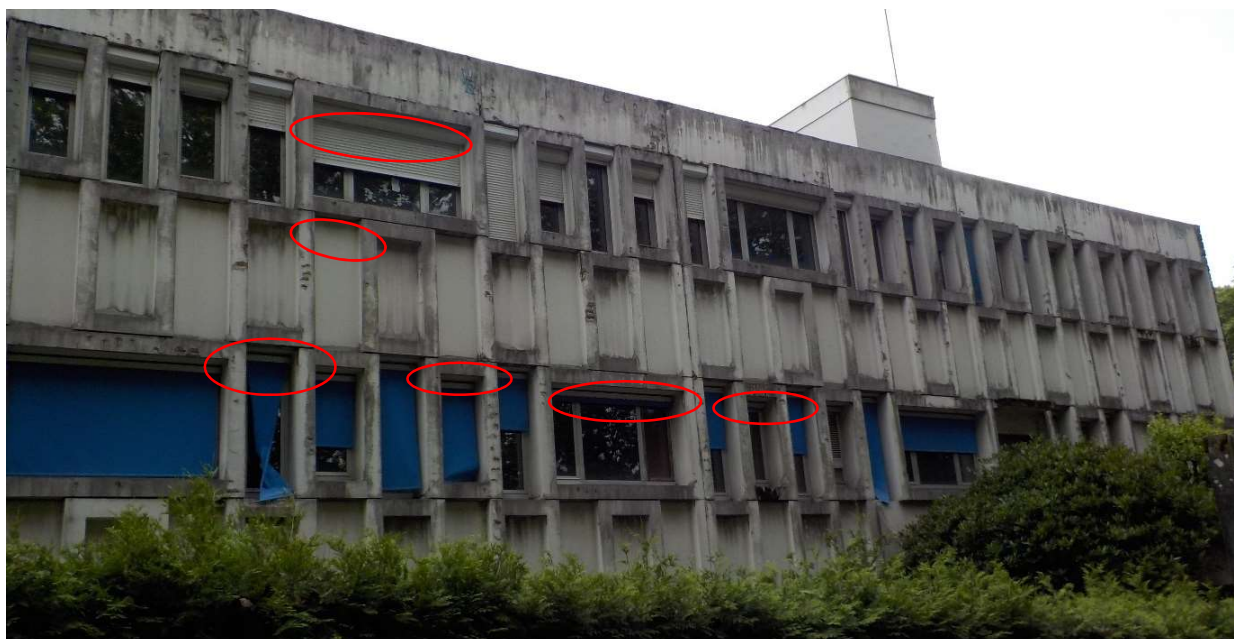
Photo n°7. Bâtiment « La Mère et l'Enfant » en béton délabré mais présentant de nombreuses anfractuosités en façade pouvant être utilisées par la faune (chiroptère, Martinet, ...)
