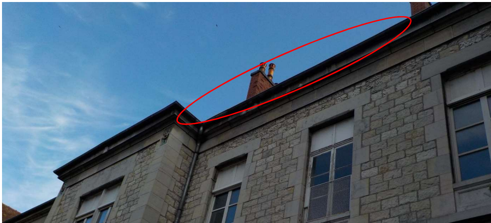
Photo n°5. Espace entre le chéneau et la toiture où se glissent les Martinets pour nicher
