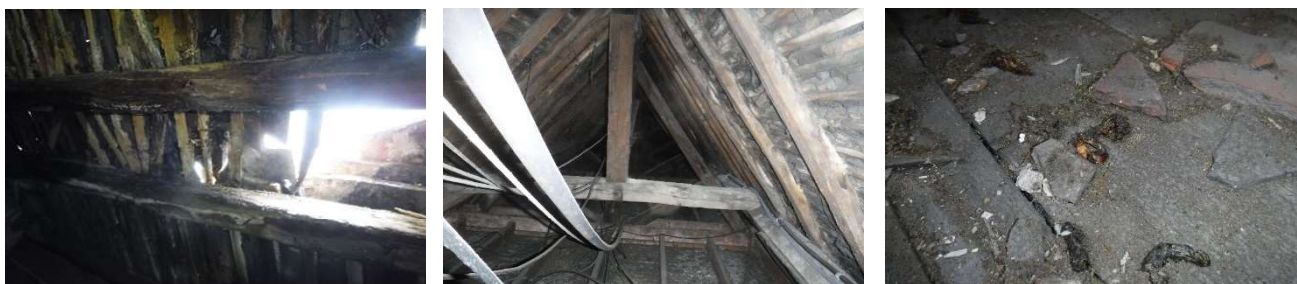
Photo n°12. Combles (Saint-Joseph) avec ouvertures, poutres en bois, toiture en tuiles et fèces de fouine
