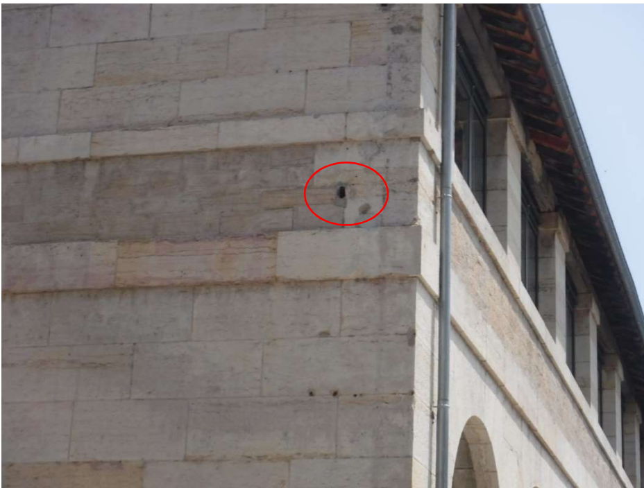
Photo n°9. Trou dans le mur entre des pierres (façade ouest du bâtiment B)
