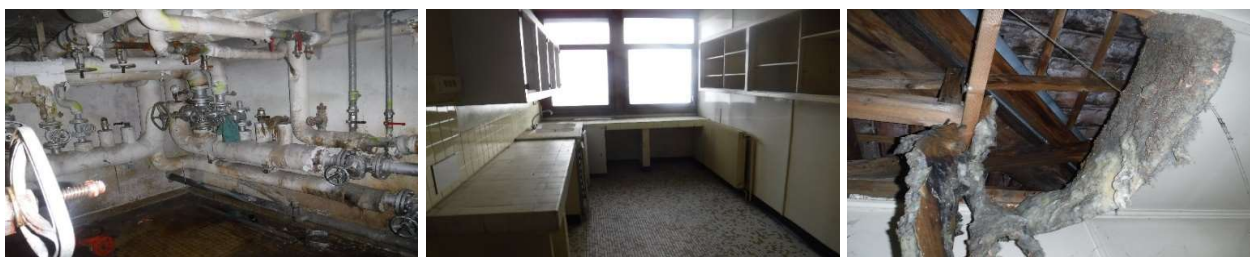
Photo n°14. Sous-sol avec fuite d'eau, bâtiment abandonné et plafond des pièces s'effondrant offrant un accès sous les tuiles
