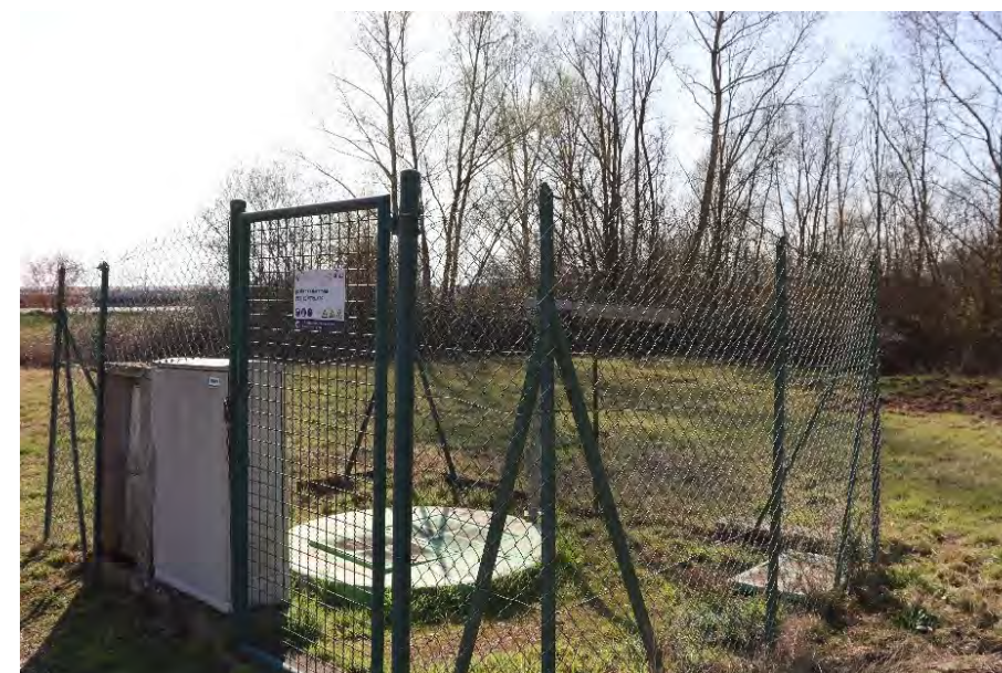
Photographie 10 - Poste de relevage Petits Vernats (source : Eco-Stratégie, le 23.03.22)
