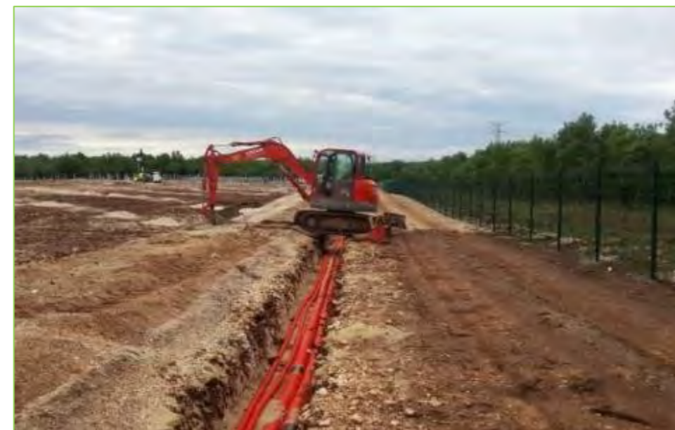
Figure 24 – Exemple de tranchée pour la mise en place des câbles électriques (source : ECO-STRATEGIE)
