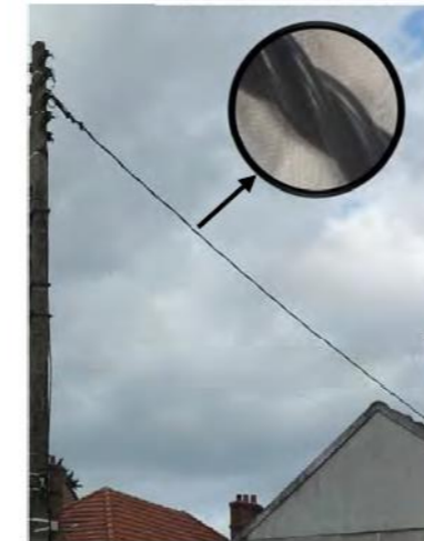
Réseau fils isolés aérien BT
