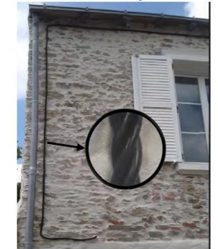
Réseau fils isolés façade BT
