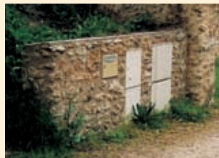
▲ Lors de la conception des clôtures il faut prévoir l'intégration des équipements techniques. On peut aussi placer les coffrets, en retrait dans le mur, derrière un portillon en bois en façade.
