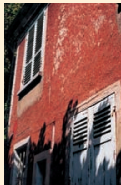
Ponctuellement, on rencontre des enduits très vifs. ▼
