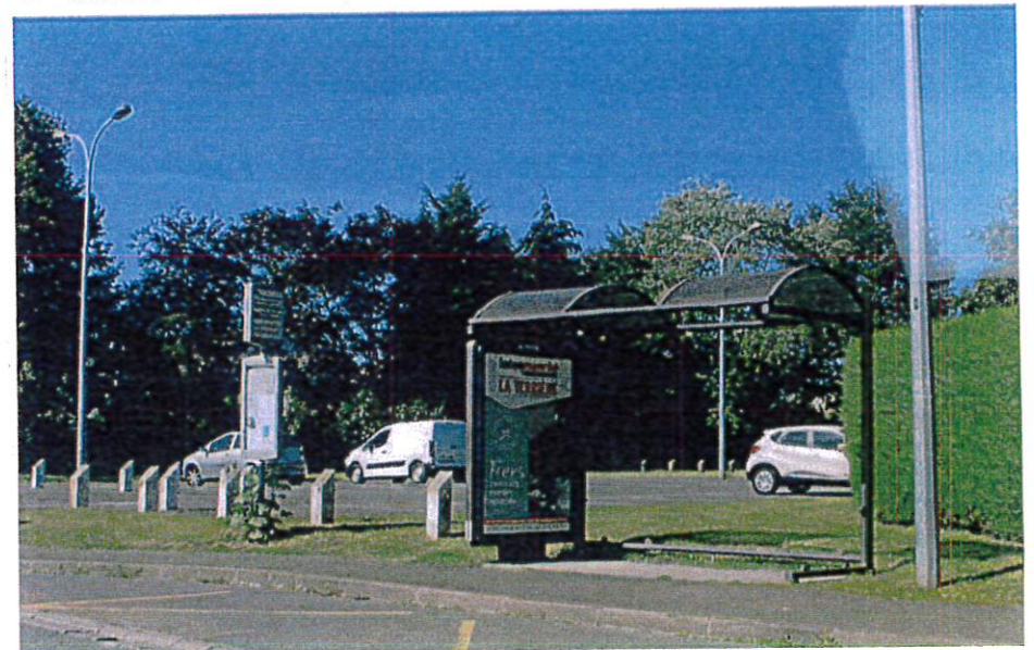
05 - abribus non entretenu et partiellement démonté
