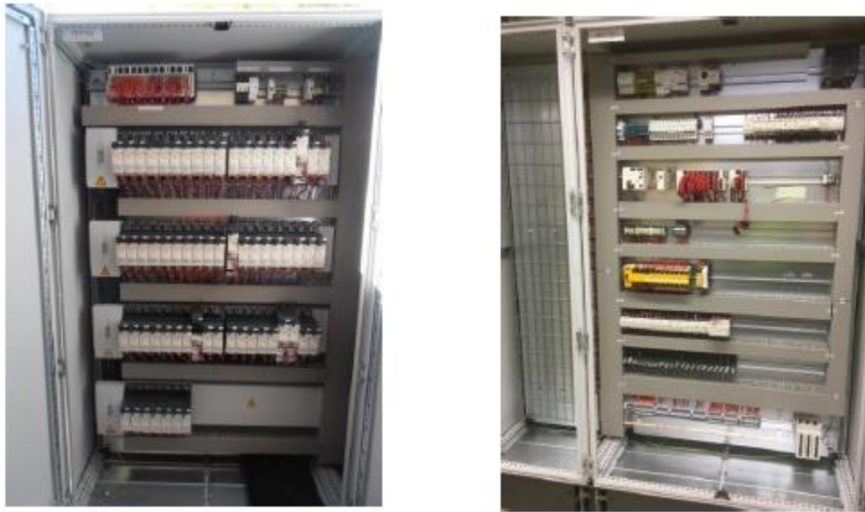
Figure 56 : Vues illustratives armoire moteur (gauche) et armoire automate (droite)
