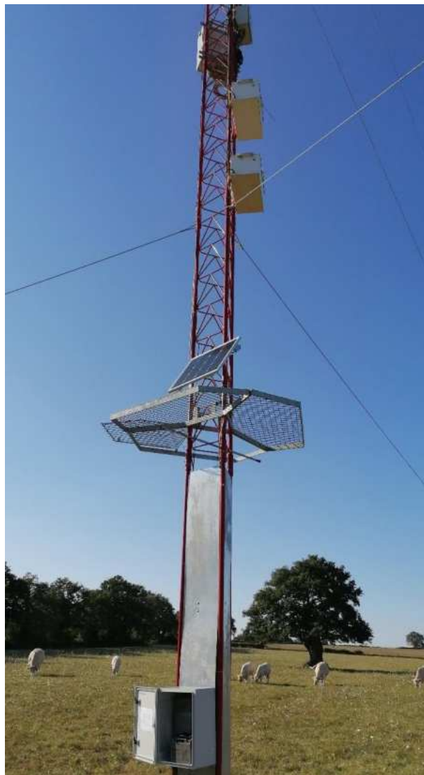
Photographie du mât de mesure disposé sur site
