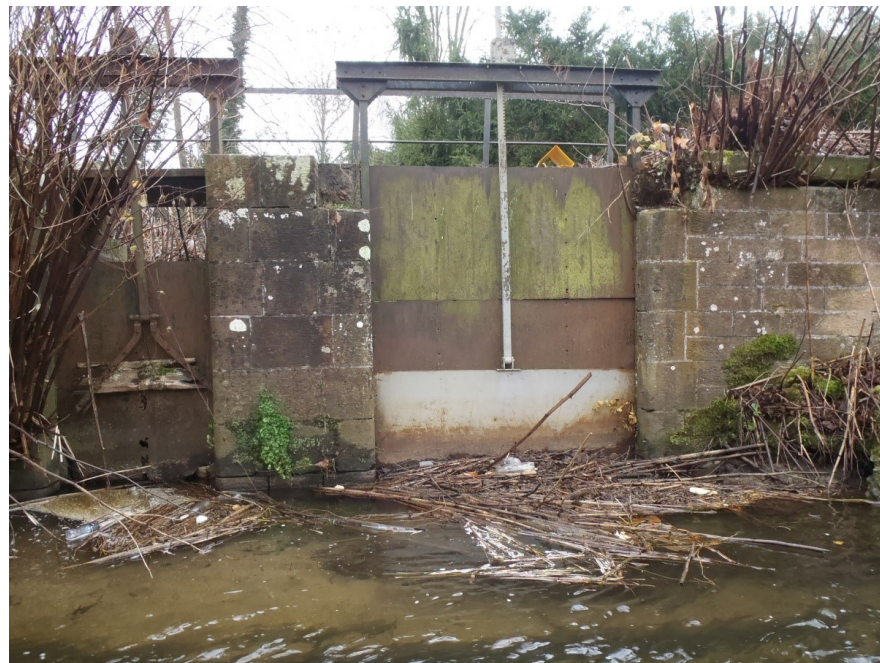
Illustration 68 : Vannage en entrée du Muelbach
