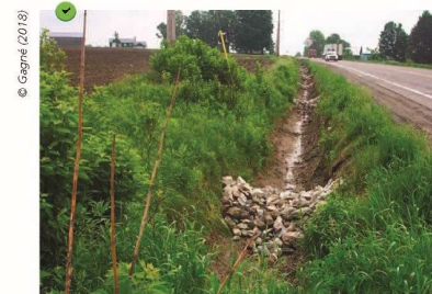
Fossé avec seuils en série.
