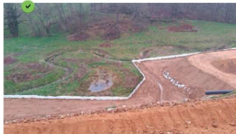
Barrière de rétention longeant un cours d'eau.
