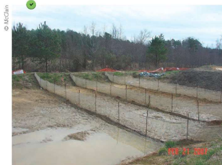
Bassin de décantation équipé de barrières perméables. Une fois le bassin vidangé, les sédiments sont prêts à être curés.
