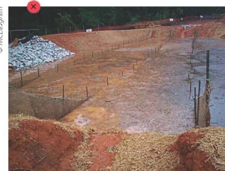
L'eau ne doit pas passer par-dessus les barrières.
