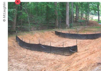
Les barrières perméables en géotextile ne sont pas tendues jusqu'aux talus du bassin de décantation.
