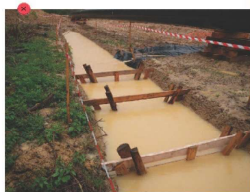
Fossé de décantation inefficace, sur sols très argileux, les particules les plus « fines » ne décantent pas.
