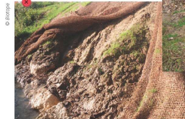
Infiltrations d'eau sous le filet et déstabilisation de l'ensemble du dispositif.
