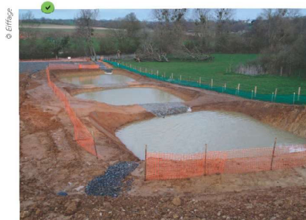
Bassin de décantation constitué de trois sous bassins successifs.
