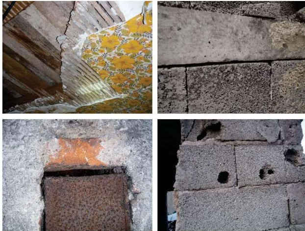
Figure 4 : fissures et anfractuosités difficiles d'accès
