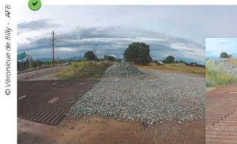
Fosse drainante et grille métallique ondulée.
