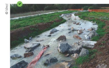
Rejet temporaire au sein d'une dérivation provisoire équipée de blocs dissipant l'énergie hydraulique.
