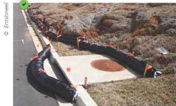
Type 4 : dérivation en place pour éviter que l'eau chargée ne rentre dans l'avaloir.
