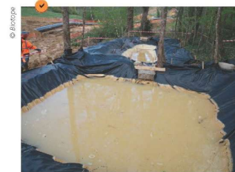
Dispositif de surverse à gabion de paille.
