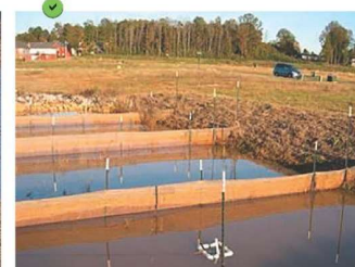
Basin de décantation dont les talus sont décaissés et végétalisés. Équipement : chicanes en toile de jute fixée à des piquets en acier et vidangeur flottant de type « skimmer ».
