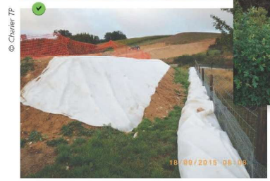
Contrôle du périmètre coté bas d'un dépôt provisoire à l'aide d'un merlon de copeaux de bois et d'un boudin de rétention.
