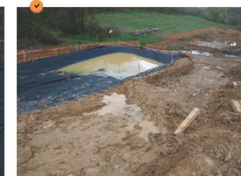
Piège à sédiments hors-sol : rapport longueur/largeur adapté mais absence d'un dispositif de surverse.
