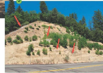
Traitement de talus : en haut de pente l'enrochement d'une rigole dirige l'eau hors pente, et plusieurs banquettes offrent une surface plane pour une implantation végétale.
