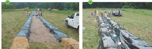
Configuration de traitement pour un pompage et rejet : photo de gauche vue d'aval avec la toile en jute pour retenir les sédiments coagulés, et la photo de droite avec les blocs de PAM attachés le long du fossé de traitement.
