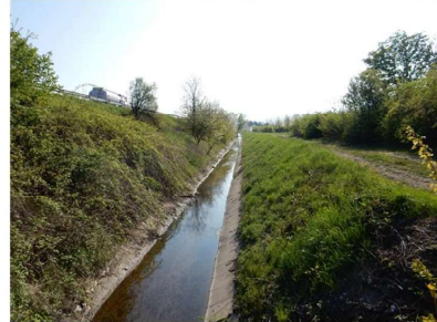
Figure 2-4 : Fossé d'évacuation des eaux de pluie vers le Giessen
