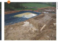
Piège à sédiments hors-sol - rapport longueur/largeur adapté mais absence d'un dispositif de surverse.
