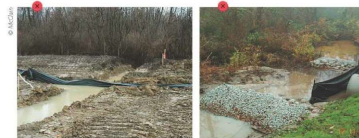
Ne pas installer de barrière de rétention en contre-bas d'un talus.
