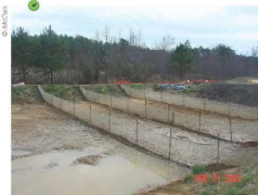
Bassin de décantation équipé de banquettes perméables. Une fois le bassin vidangé, les sédiments sont prêts à être évacués.
