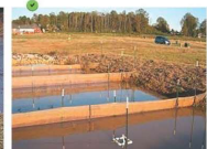
Bassin de décantation dont les talus sont alcalinisés et végétalisés. Equipement : chicanes en bois de type Gawe à des pieux et acier et visangeur flottant de type « skimmer ».
