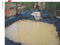
Bassin de décantation inefficace : forme inadéquate ne permettant pas d'assurer correctement la sédimentation.
