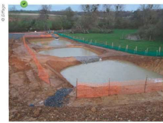
Bassin de décantation constitué de trois bassins successifs.
