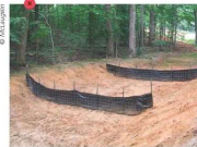
Les barrières perméables en géotextile ne sont pas tendues jusqu'au talus du bassin de décantation.
