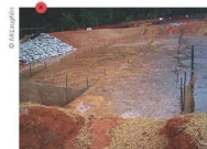
L'eau ne doit pas passer par-dessus les barrières
