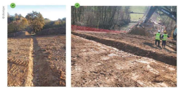
Chantier successives, sur une piste provisoire de circulation des engins, collectant les écoulements superficiels et les dirigeant vers une zone adéquate (cluse de part et d'autre de l'emprise du chantier). Les points de rejet sont munis de dispositifs anti-érosion.
