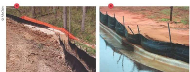
La pose de barrières de rétention n'est pas une mesure suffisante pour lutter contre l'érosion des sols, gérer les écoulements superficiels et traiter les sédiments. Il importe d'adapter une approche multi-barrières combinant plusieurs bonnes pratiques environnementales.
