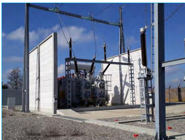
Exemple d'un transformateur avec murs pare-feu
