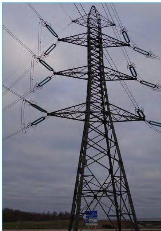
Pylône n°104N : hauteur 55 mètres, emprise au sol 8x8 mètres, largeur de nappe 17 mètres
