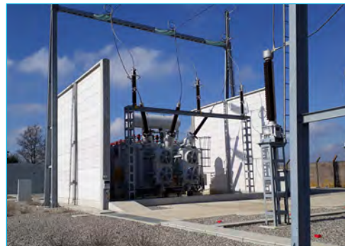
Transformateur avec murs pare-feu
