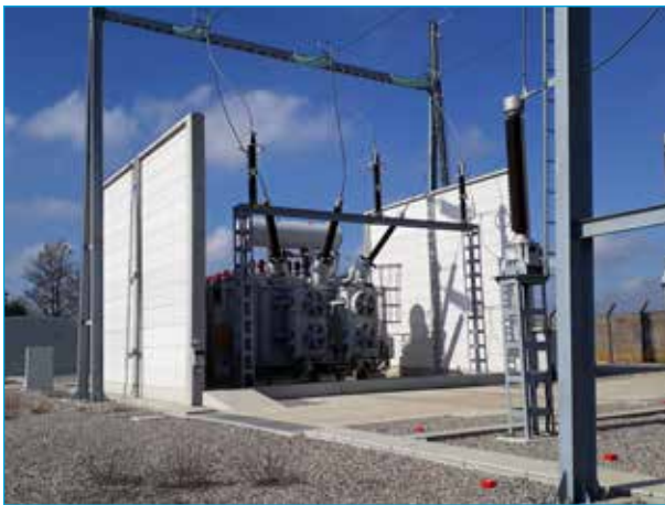
Exemple d'un transformateur avec murs pare-feu
