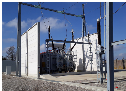
Transformateur avec murs pare-feu
