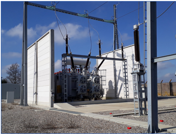
Exemple d'un transformateur avec murs pare-feu
