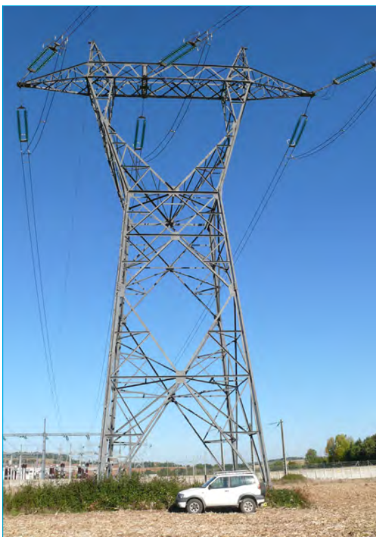
Pylônes A et B de sortie de poste : hauteur 30 mètres, emprise au sol 9x9 mètres, largeur de nappe 20 mètres
