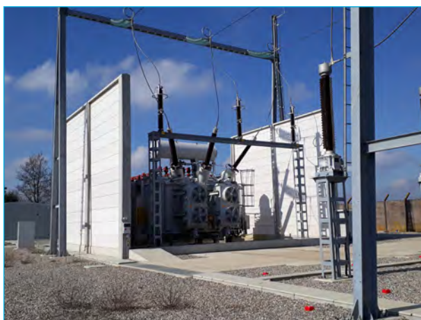
Exemple d'un transformateur avec murs pare-feu
