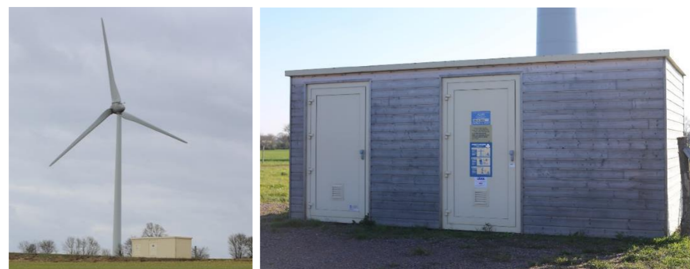
Photo 5 : exemples de poste de livraison électrique
