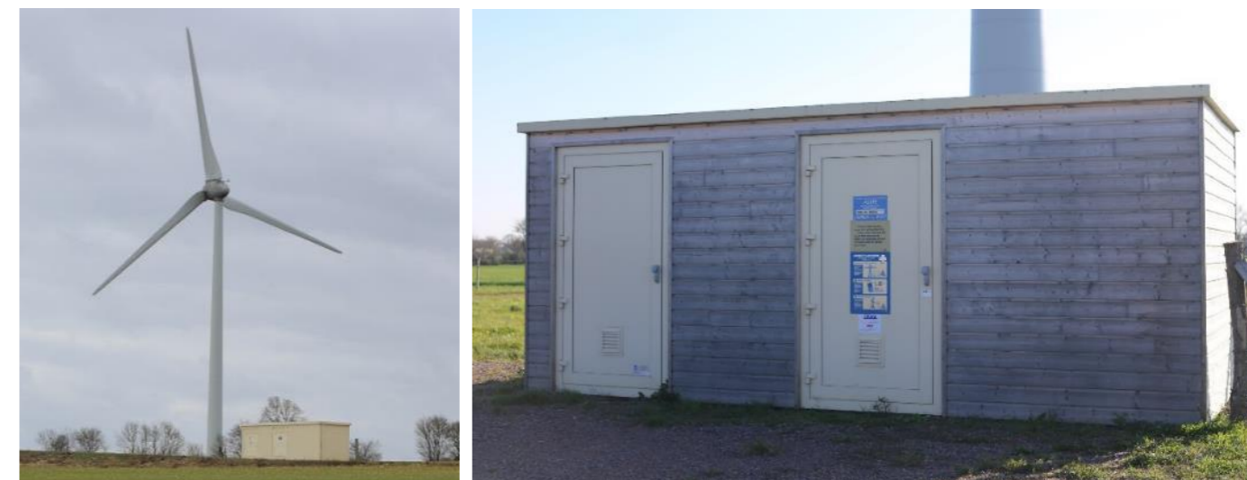
Photo 195 : Exemples de poste de livraison électrique
