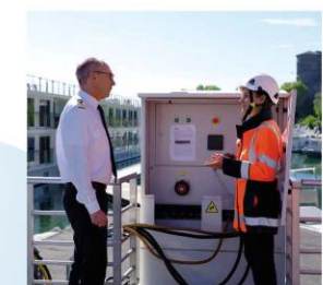
Borne recharge électrique pour l'alimentation électrique des bateaux à passages de Fourson-sur-Rhône (73)
