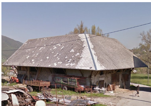
Photographie de la construction concernée par l'identification d'un potentiel changement de destination sur la parcelle D0311
