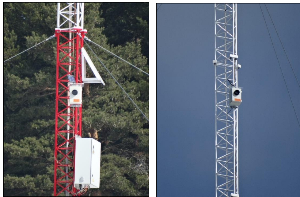
Figure 6 : Clichés du positionnement d'un module Batcorder autonome sur mât de mesure (à gauche : proche du sol, à droite : en altitude)
