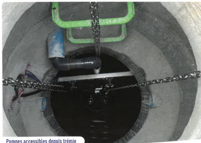
Pompes accessibles depuis trémie
