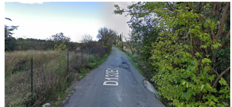
Etat de la chaussée de la RM132E1
