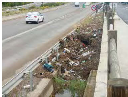
Embâcles sur ouvrage d'évacuation RD66
