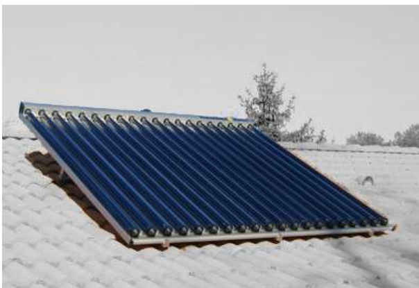
Capteurs solaires thermiques
