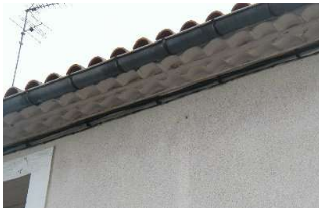
42 rue des Aiguerelles Débord de toit sur génoise deux rangs avec gouttière pendante en zinc.
