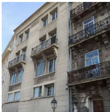
La mise en place de doubles fenêtres au nu extérieur nuit à l'harmonie d'origine
