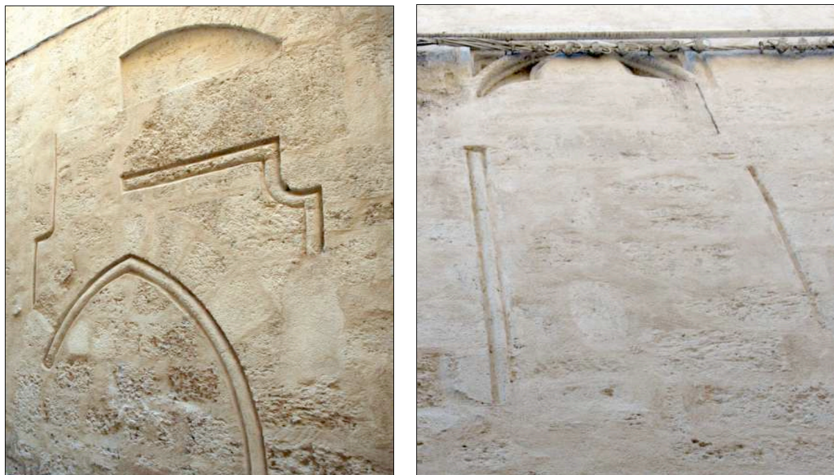
Fig. 40 impasse Broussonet — vestiges de deux portes médiévales successives et de fenêtres à intrados trilobé
