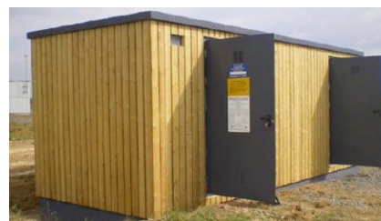
Exemple de poste de transformation bardé Source : OECO Architectes
