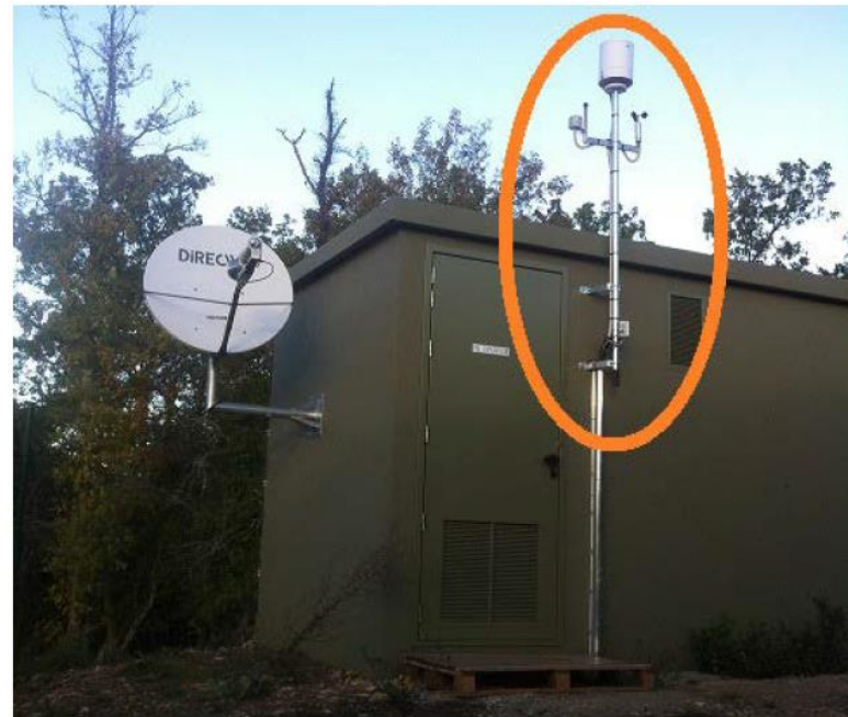
Exemple de station météo
