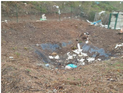
Photo 8 et suivantes : Bassins de rétention 1, 2 et 3.
