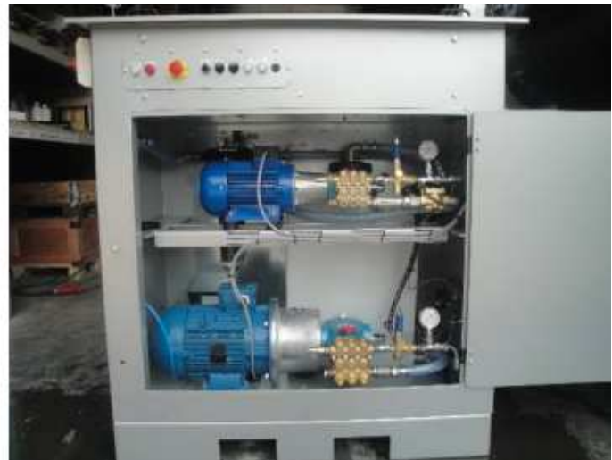
Pompe et système de filtration/désinfection
