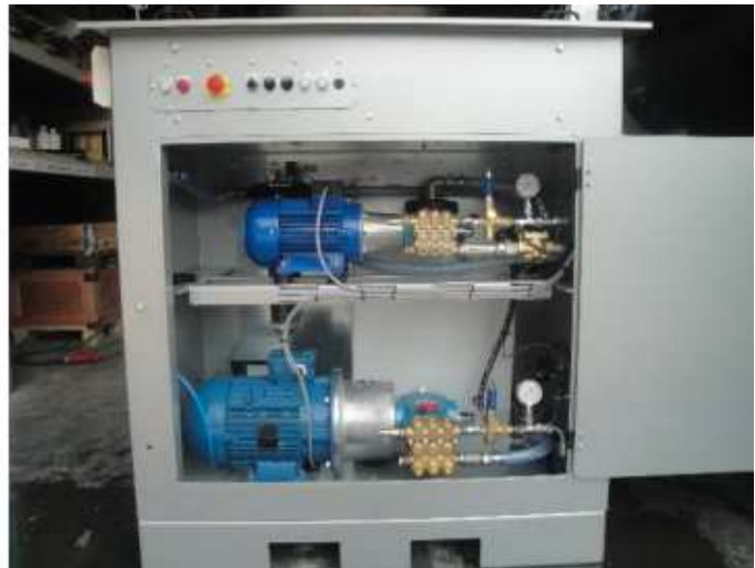
Pompe et système de filtration/désinfection
