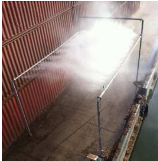
Structure intégrée au broyeur
