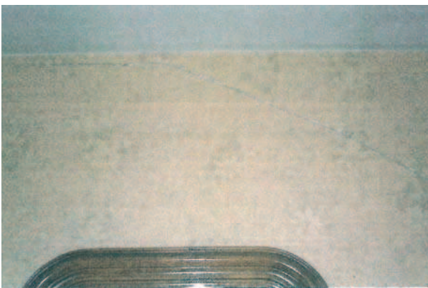
Fissuration intérieure, tapisserie déchirée - Maison André.
