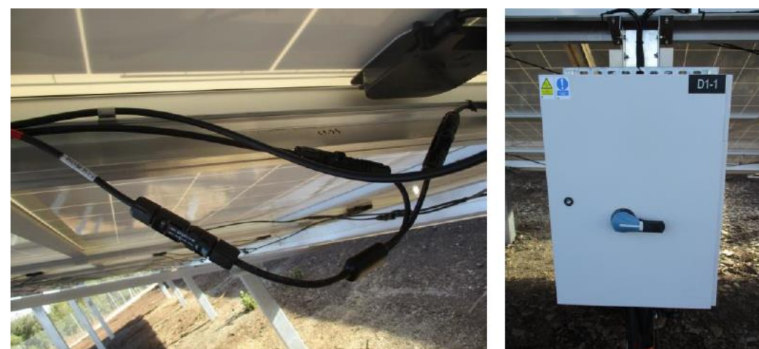
Photo 10. Exemple de câble électrique et de boîte de raccordement 15
