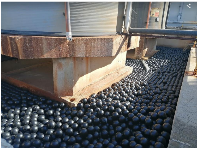
Exemple de couverture de la rétention 122/128 (future 9/11/12).
