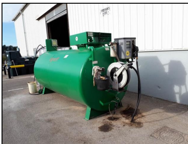
Poste de stockage et distribution de gasoil routier
